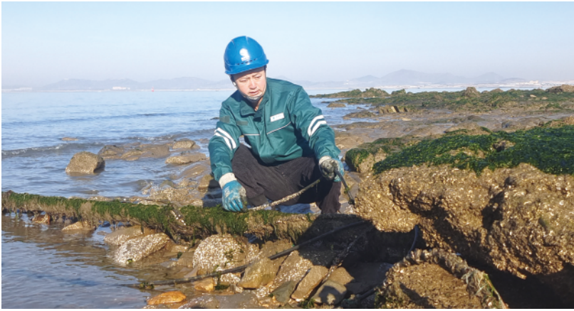
宋林在田横岛海岸检查海底电缆运行情况。
