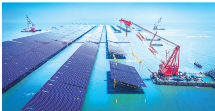
中电建青岛即墨海上光伏项目。
