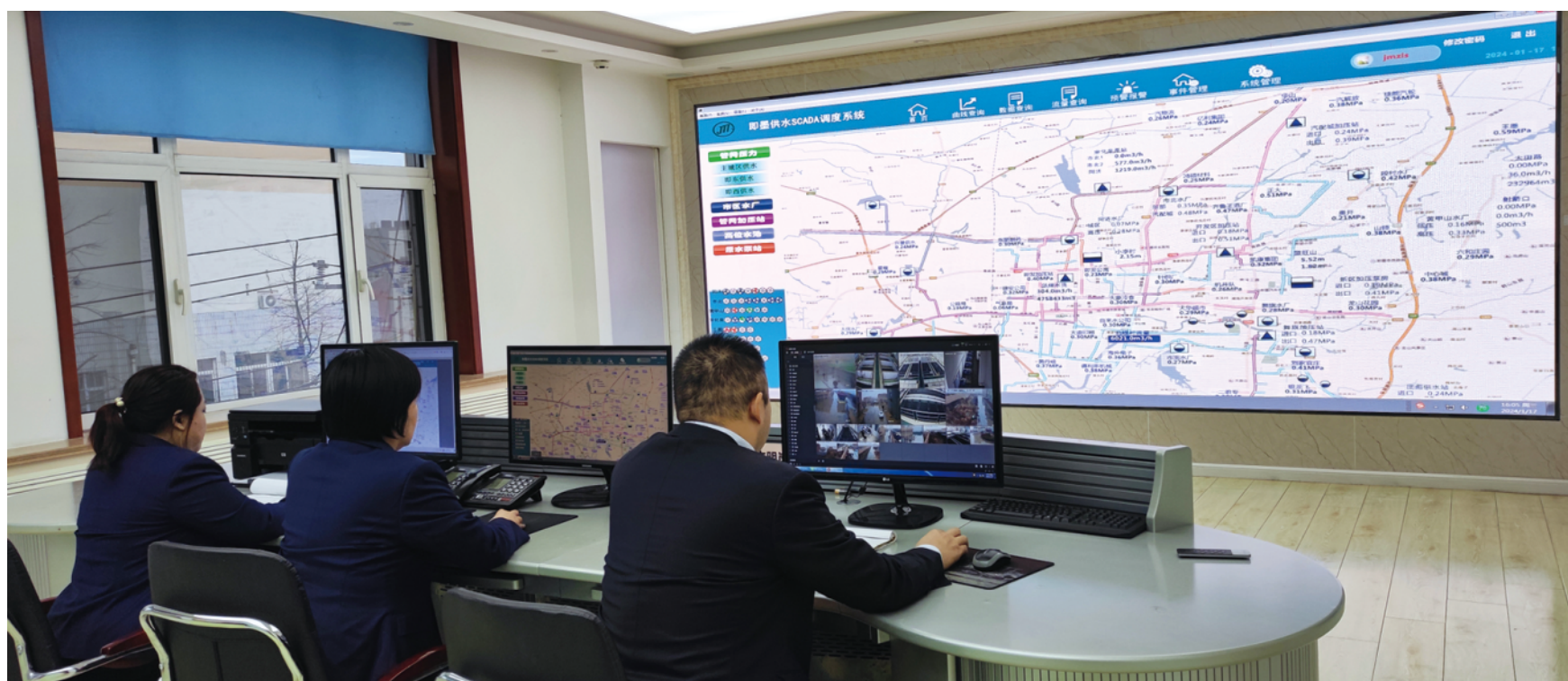
调度中心工作人员通过调度系统监测供水管网运行情况。
