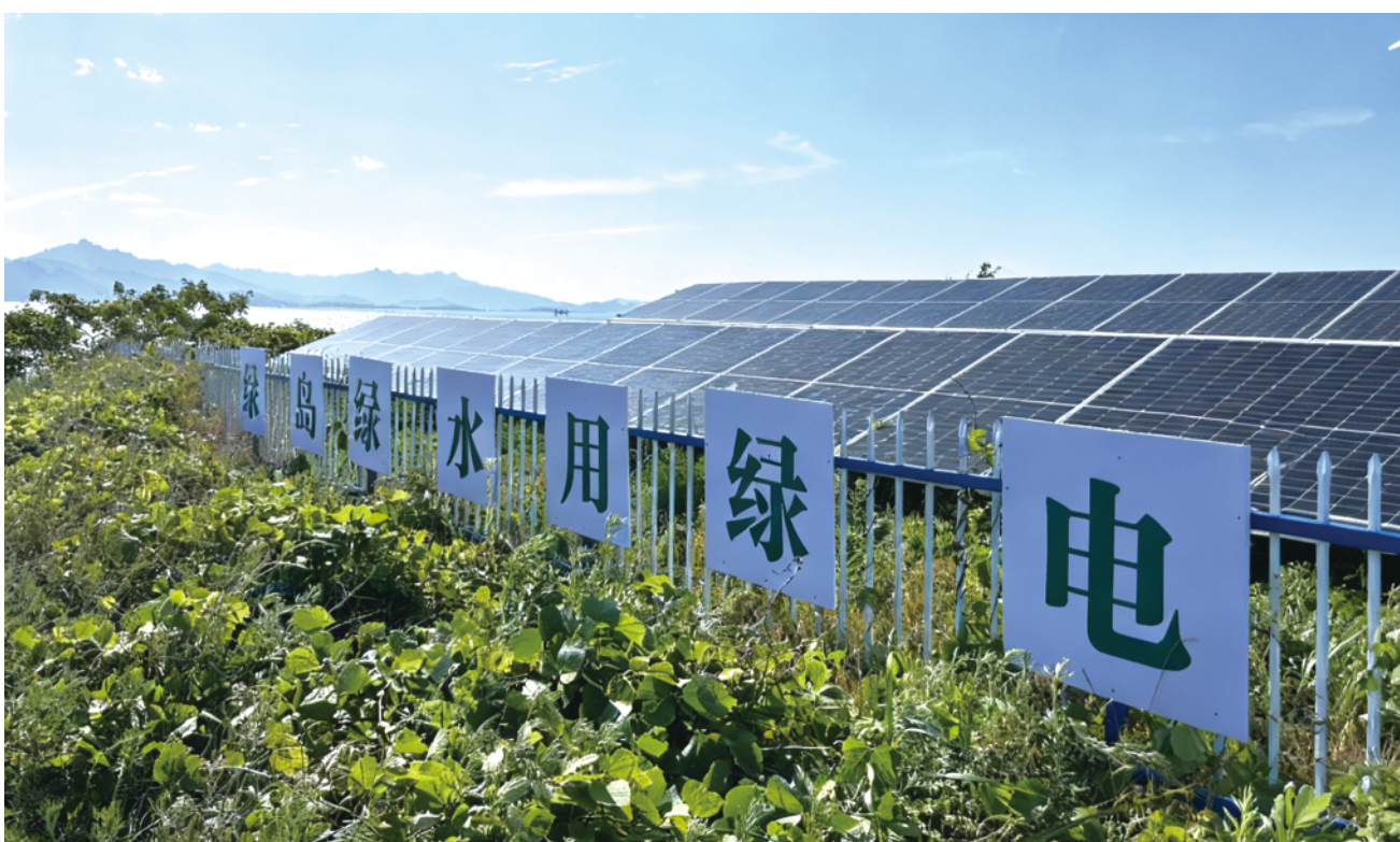
大管岛“风光储”一体化高可靠绿电供应示范项目。
