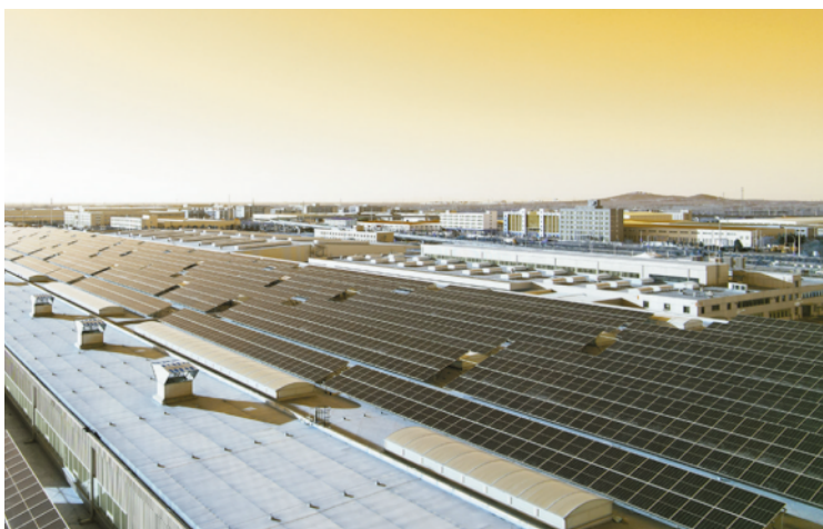
一汽-大众华东基地厂房屋顶整齐排列的光伏板。
