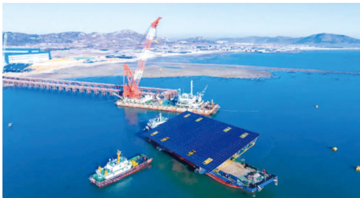
海上光伏项目。
