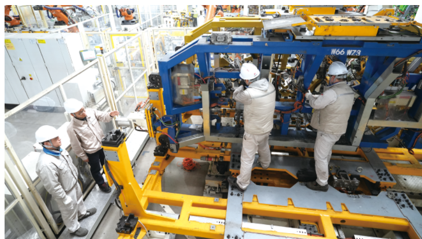
改造中的一汽大众宝来车型换代项目焊装车间。邢志峰 摄
