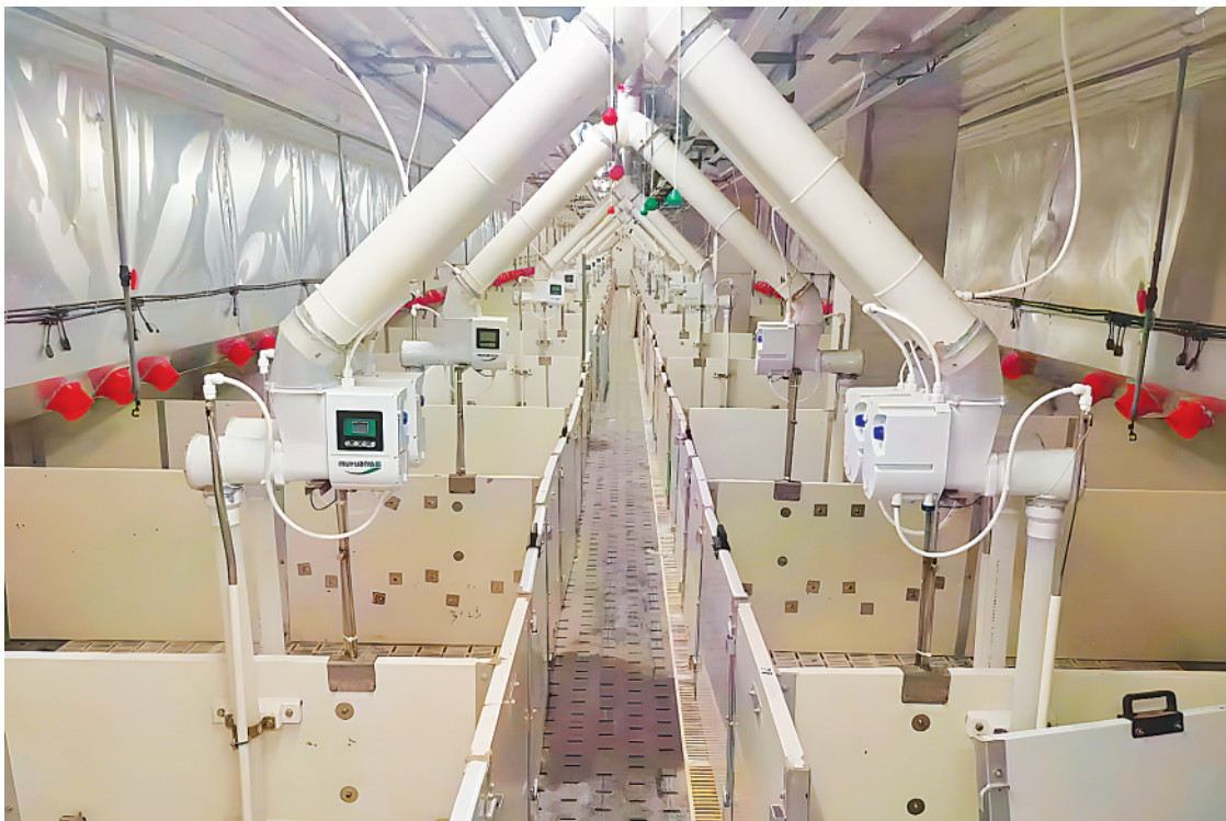
在青岛牧原农牧有限公司,6层、30米高的“楼房猪舍”更像是一座现代化的养殖工厂。与普通猪舍相比,“楼房猪舍”虽然建设成本高,但使用寿命长,同时土地利用率更高。该项目占地80余亩,年出栏生猪可达10万头,相比传统猪舍,可节约土地400亩。图为企业智能饲喂器。
