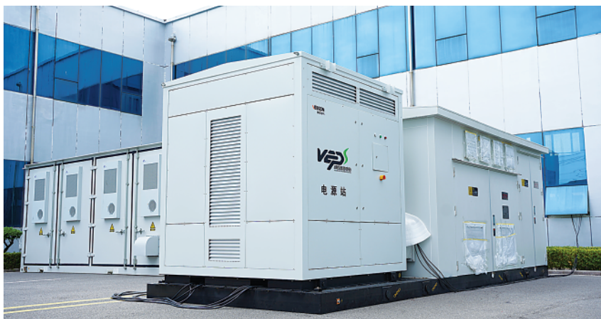
构网型储能系统现场实景。
