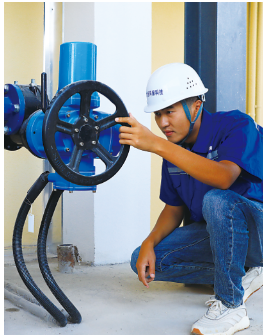
城西污水处理厂工程师正在调试设备。(姜兆荣 摄)
